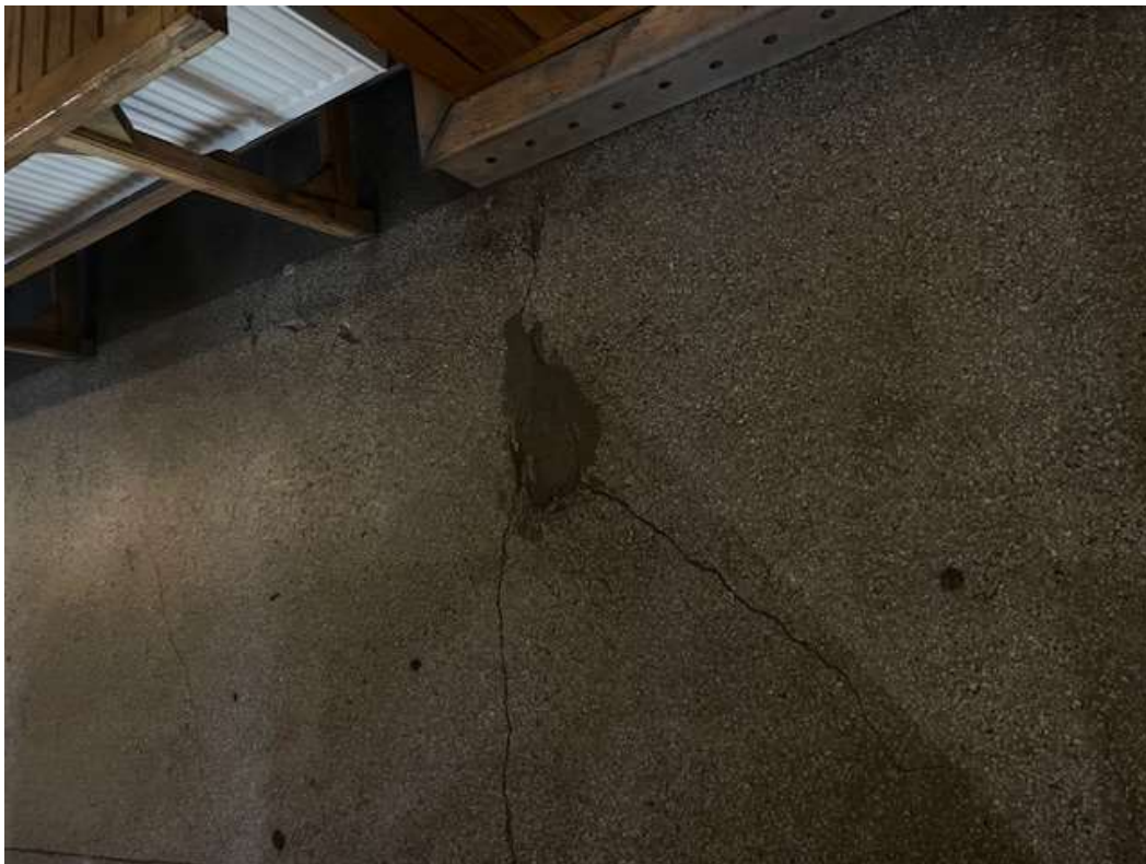
Fot. 1 i 2 Widoczne spękania ubytki i wykruszenia istniejącej nawierzchni z lastryko.
